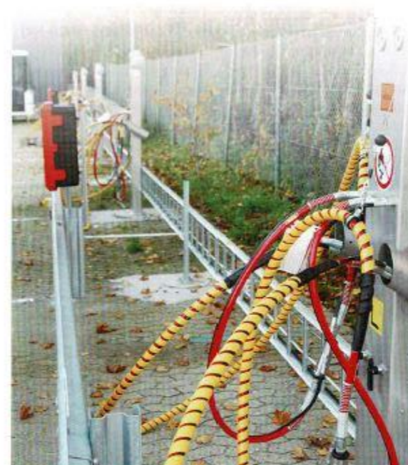
10 slowfill-anlæg leveret af Nærenergi står klar til påfyldning af biogas, når lastbilerne "overnatter".
